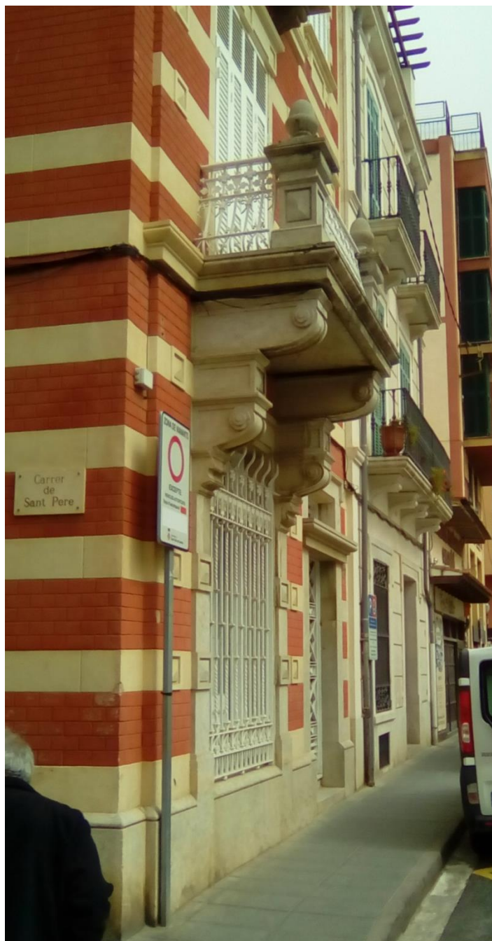
Destall del balcó principal amb les mènsoles i pilastres. També s'aprecia l'estucat que reproduïx l'obra vista i les franges de color crema que reproduïxen la pedra natural.
